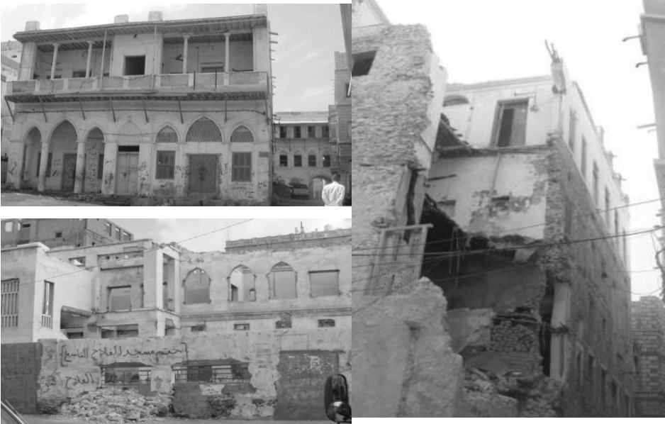
شكل رقم (19) المباني المهمل والمهجورة والمهدمة.
